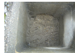
インバート未設置
