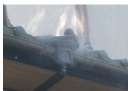
雨どいなどから 煙が出る
